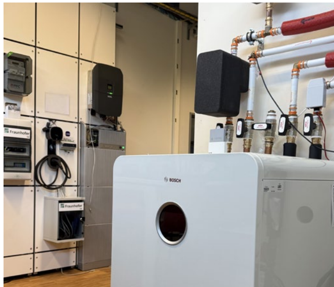
Abbildung 3: Aufbau der Laborumgebung mit Wärmepumpe, Heimspeicher, Hybridwechselrichter, SMGW und CLS-Adapter am Fraunhofer ISE in Freiburg
